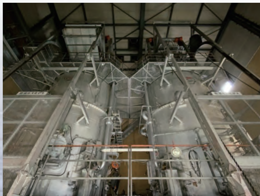
乾溜ガス化式焼却炉
