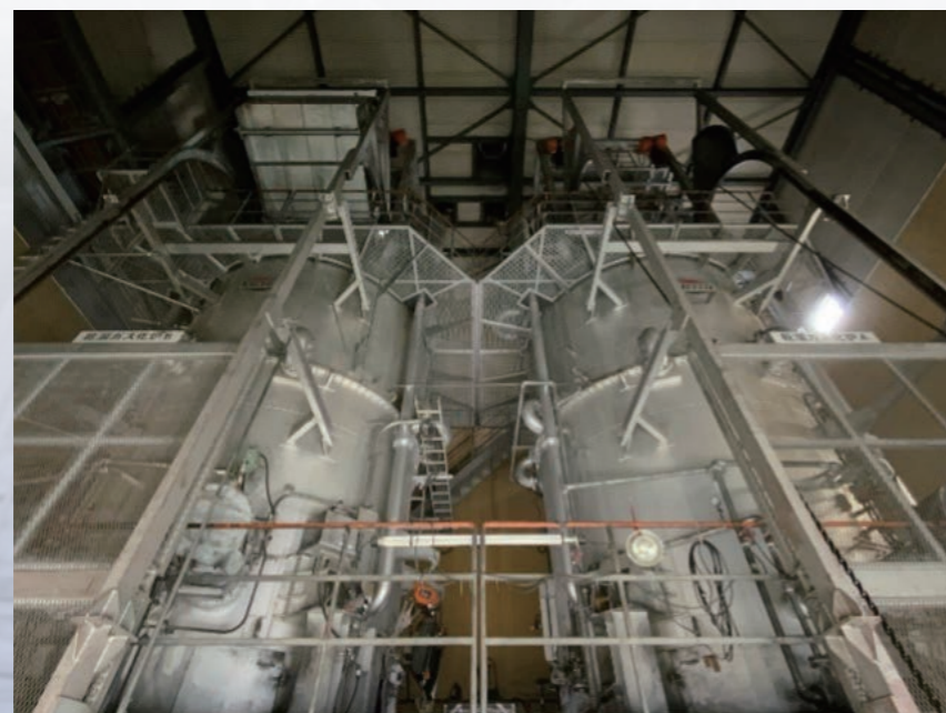
乾溜ガス化式焼却炉
