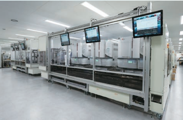
新搬送システム(全景)
