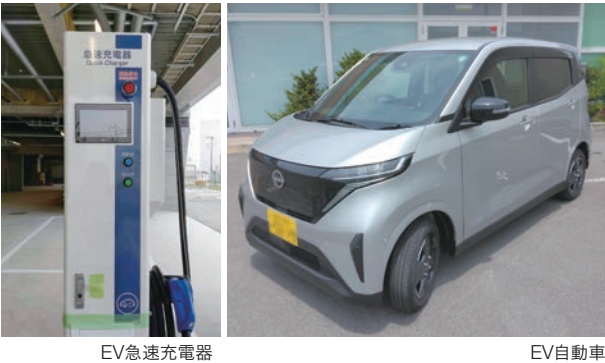
EV急速充電器
